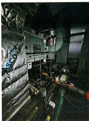
ÁREA TÉCNICA - AVAC
